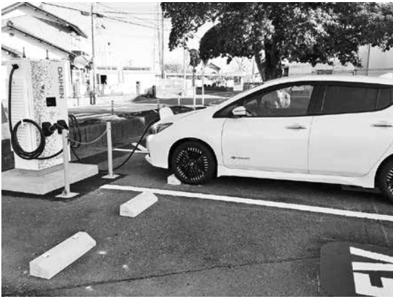
電気自動車用急速充電器（庁舎北側駐車場）
