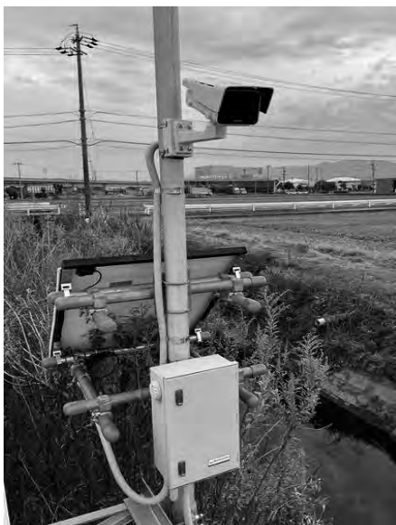
加納川に設置されている監視カメラ
