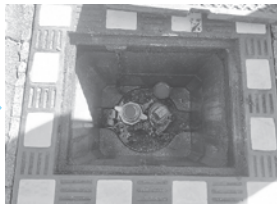
⑤地下式消火栓内部
