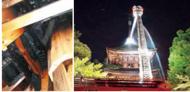
▲令和6年7月 雷による火災が発生し、心柱などが焼けました。文化庁の調査官による現地調査が行われ、令和7年7月に修理工事が開始されました。
