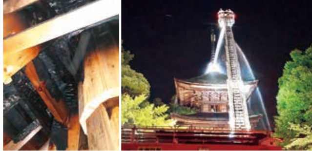
▲令和6年7月 雷による火災が発生し、心柱などが焼けました。文化庁の調査官による現地調査が行われ、令和7年7月に修理工事が開始されました。
