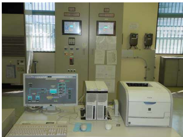
写真 2.3 中央水源地監視装置
